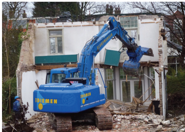
Afbraak Merelstraat 1A, begin 2012, foto Wim van de Velde & Marijke van Rijn.
